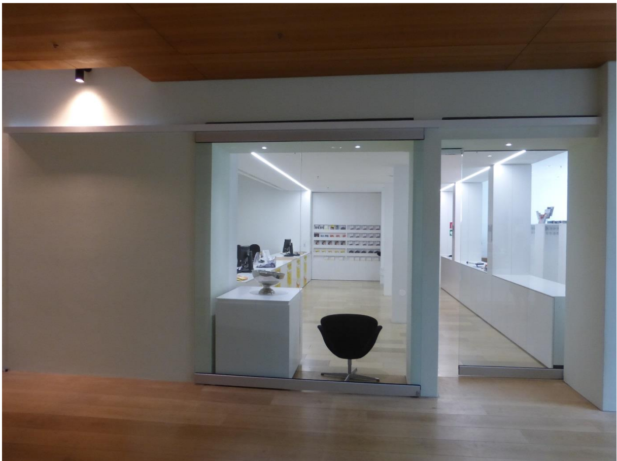
Bild 06 / Kassenmodus - Glastrennwand links bleibt geschlossen und Automatiktür ist in Funktion
